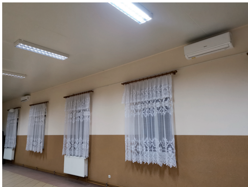
Klimatyzatory zamontowano m. in. w budynku OSP Moniaki.
