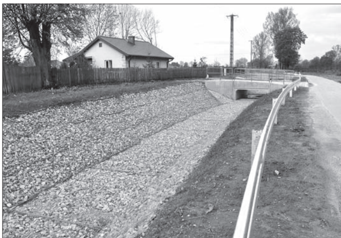
Fragment kanału Podlipie – umocnienie skarp i dna kanału w strefie zabudowy siedliskowej
