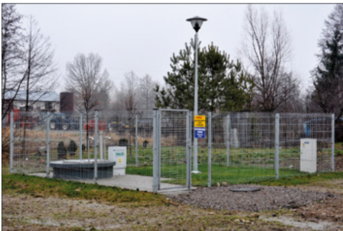
Przepompownia ścieków w Zakościelnym
