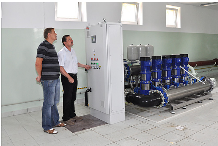
Stacja wodociągowa po modernizacji
