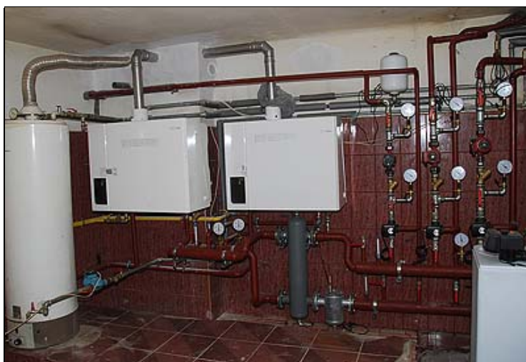
Zmodernizowana kotłownia gazowa w Zespole Szkół w Skorzycach
