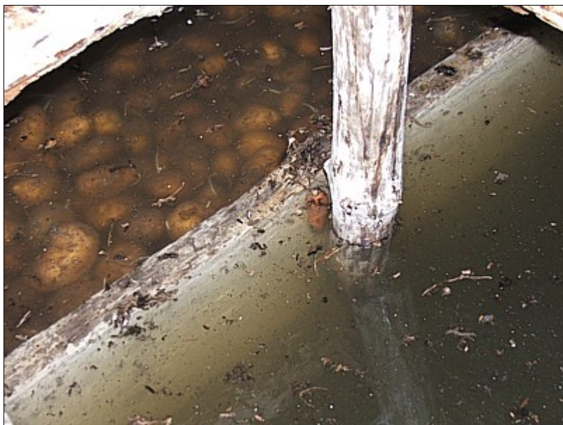
Piwnica z płodami rolnymi wypełniona wodą w sołectwie Rankowskie
