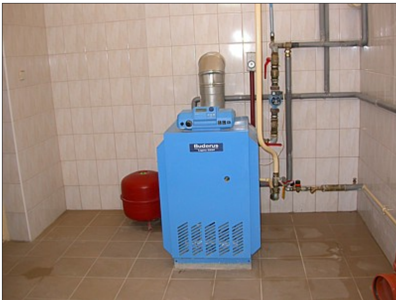
Zmodernizowana kotłownia w Ośrodku Zdrowia w Popkowicach
