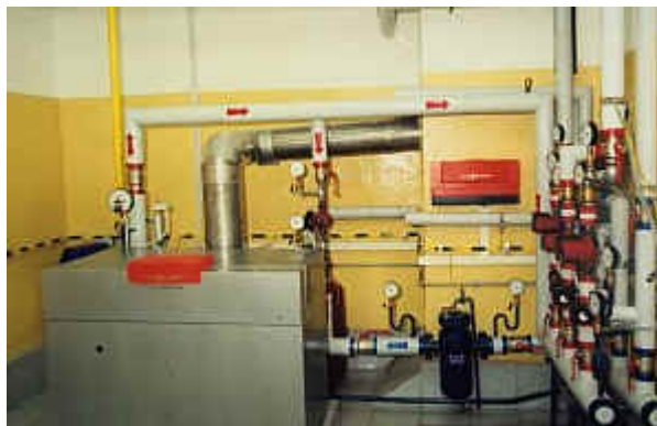
Nowoczesna kotłownia w Gminnym Ośrodku Kultury
